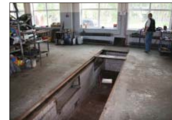
4. attēls. Nenosegta remonta bedre autoservisā – nelaimes gadījumi var notikt, netišām iekrītot bedrē vai kāpjot tai pāri.
