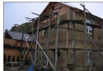
5. attēls. Prasībām neatbilstošas sastatnes – nelaimes gadījumi var notikt, krītot no sastatnēm vai tām sabrūkot.
